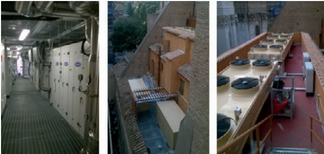
Figura 2 – La nuova installazione: due chillers condensati ad acqua, due unità di trattamento aria e due dry coolers Copyright Musei Vaticani
