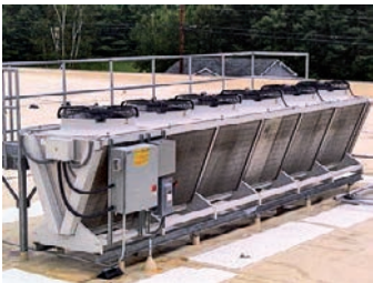
Figura 1 – Raffreddatore di gas sul tetto del supermarket di Turner
