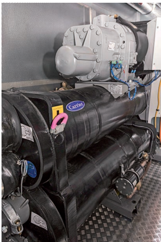
Cappella Sistina, esterno Sistema centrale del nuovo impianto di climatizzazione. Foto G. Del Gatto © Governatorato SCV – Direzione dei Musei
