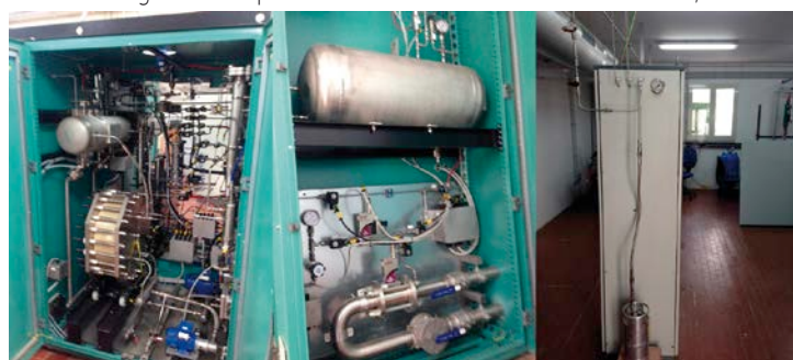
Figura 7 – L'elettrolizzatore, l'unità di miscela e il purificatore di idrogeno
